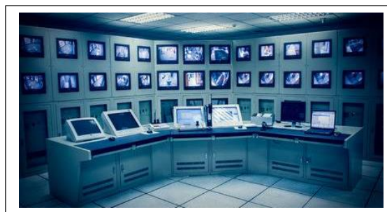
Salle de contrôle d'ordinateurs
